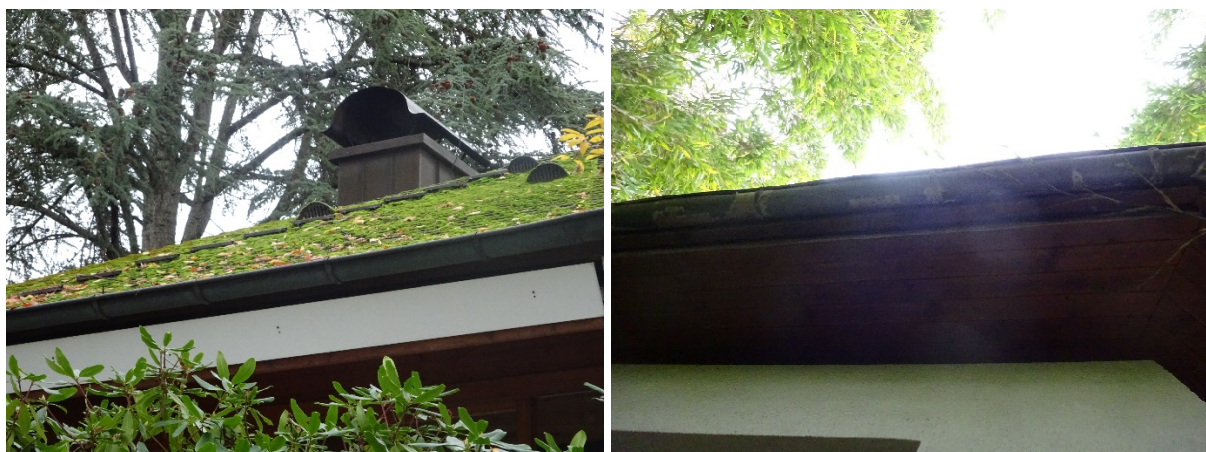
Abb. 7: Blech an Dachvorsprung (links) und Spalten in Dachvorsprung zwischen Balken (rechts)
