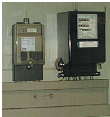
Wechselstromzähler zur Erfassung der genutzten Energie
